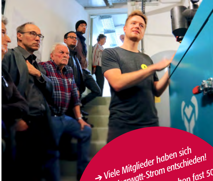
Anton Hilger von der Betreiber-genossenschaft ›Isarwatt‹ erläutert die Funktionsweise des BHKW
